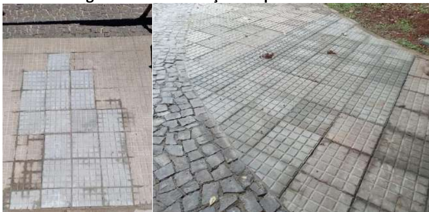
Figura 156: Manutenção em piso danificado
